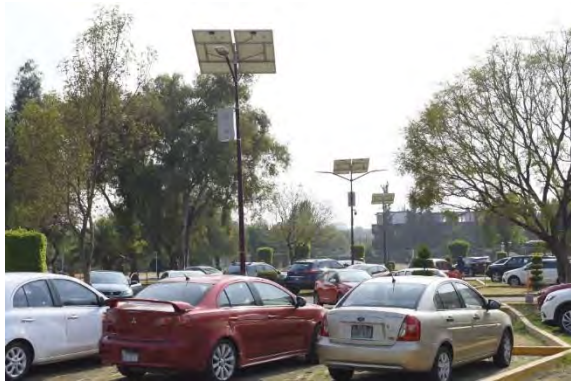
Iluminación con celdas solares
