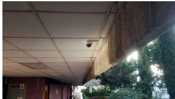
Cámara de CCTV
